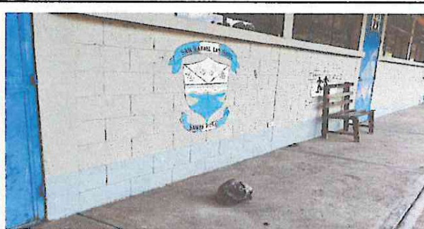
Foto 4: Pintura de paredes en mal estado.
