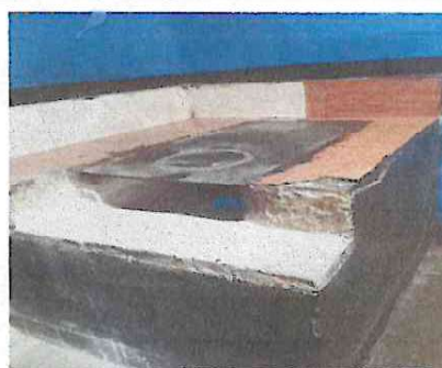
Foto 2: Daños en los azulejos
