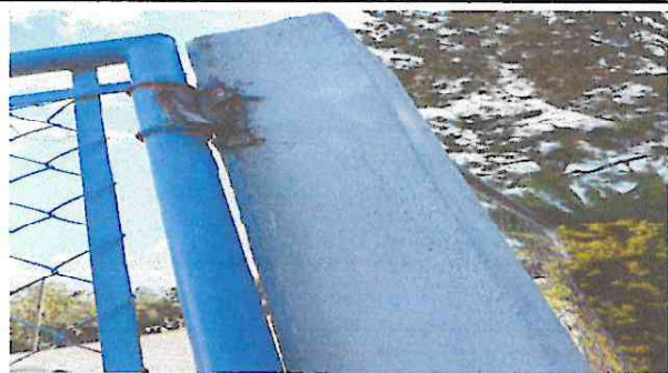
Foto 3: Piezas del porton dañado
